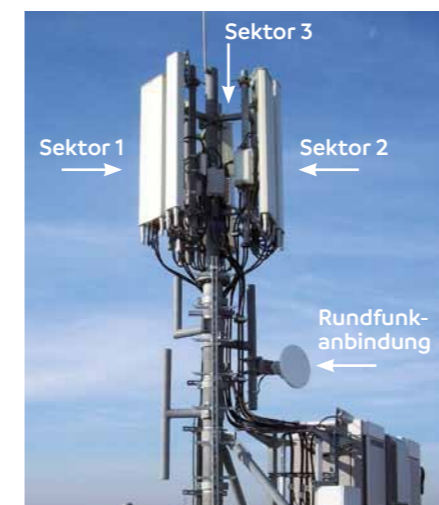
Aufbau einer Basisstation
